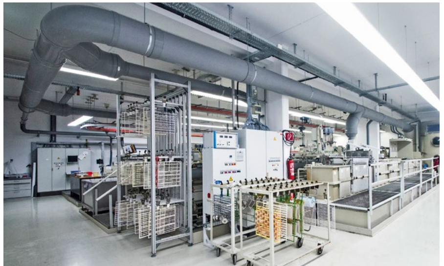
Die Gestelle werden zwar nach wie vor von Hand von einem Bad in das Nächste transportiert – das Steuern der Prozessparameter vom Gleichrichter bis zum Timer übernimmt aber die neue Steuerung.
